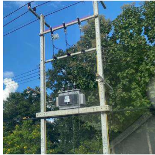
ขนาด 250 KVA
