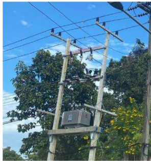
ขนาด 500 KVA
