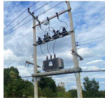
ขนาด 500 KVA
